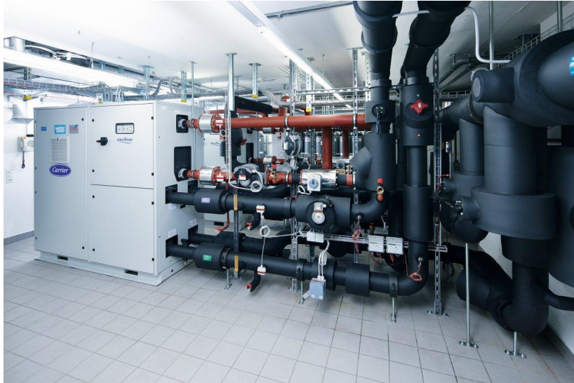
Zwei Flüssigkeitskühler mit einer Kälteleistung von je 210 kW
